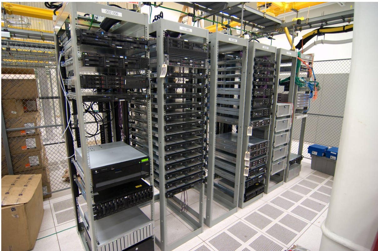
Rack con server all'interno
