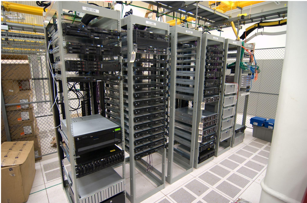
Rack con server all'interno
